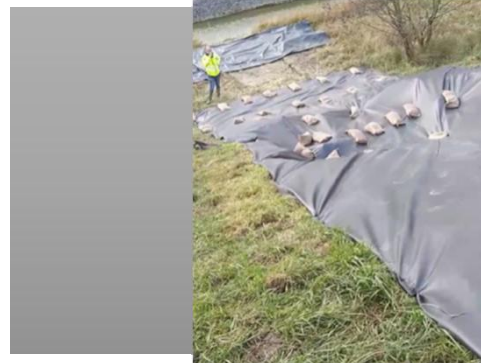
Figuur 6: Situatie op lagere deel. Losse doek op berm is overtollig en wordt verwijderd. Zandzakken zijn zo gelegd dat overstromend water makkelijk kan passeren.
