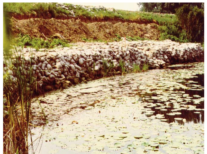
Abb. 35: Rutschung und Böschungssicherung
