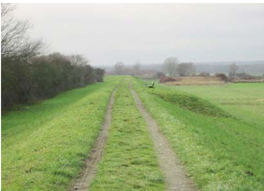
Abb. 12: Nicht ausgebauter Deich bei Erfelden
