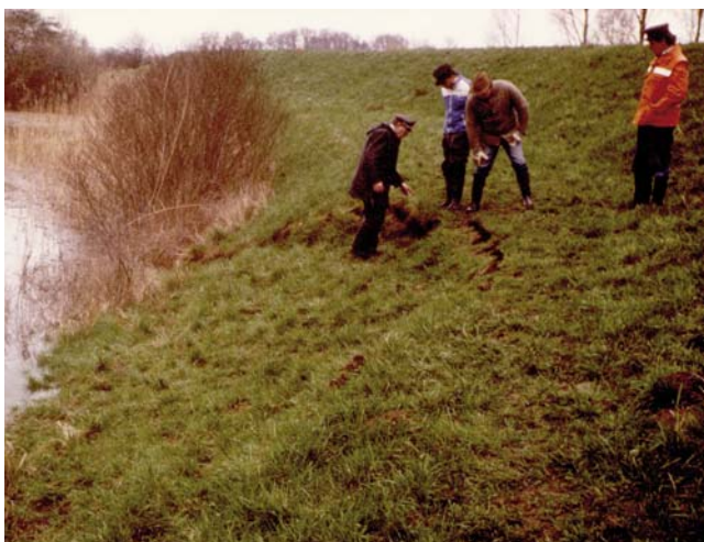
Abb. 34: Risse in der Deichböschung
