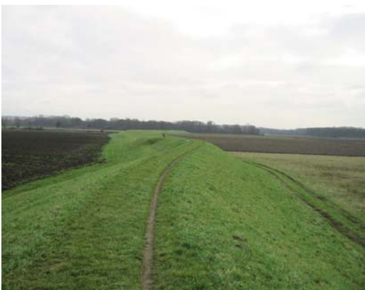
Abb. 13: Nicht ausgebauter Deich bei Erfelden
