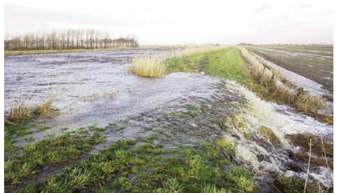
Abb. 38: Überströmung eines ungesicherten Deichs
