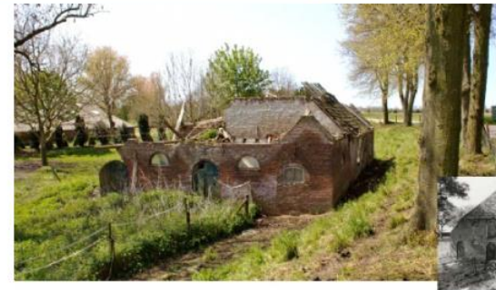
De gedeeltelijk ingestorte veeschuur was een monument en is gebouwd in de 19e eeuw. Van een groep gebouwen, ooit behorende bij een middeleeuws kasteel, compleet met slot, is bewaard gebleven en maakt nu deel uit van het nabij gelegen woonhuis, 'huis te Dieden'.
