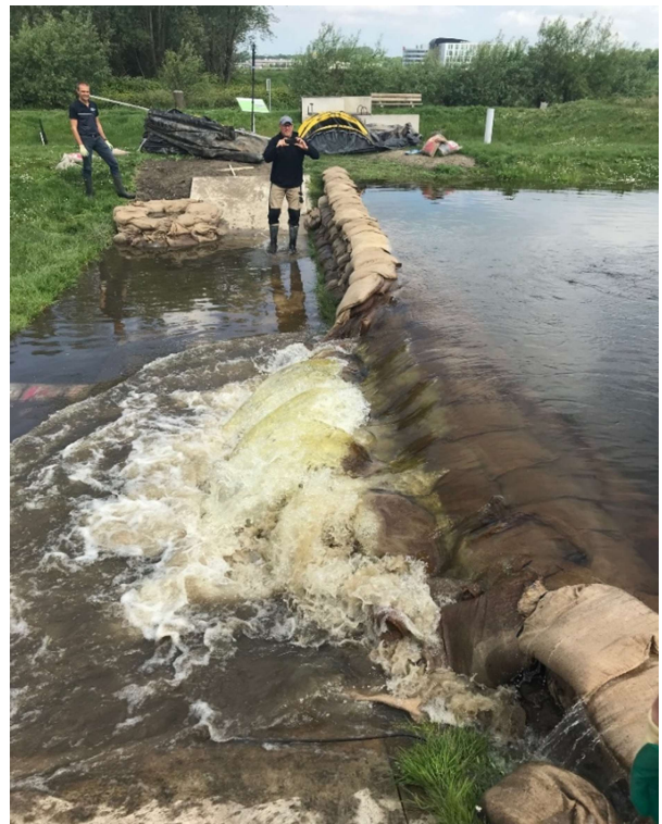
Figuur 12:Bezwijkende zandzakconstructie (Wiki noodmaatregelen, 2019)
